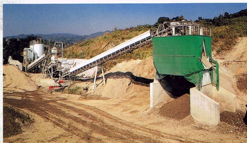
横須賀土砂汚泥改良プラント ■ 800t/日
