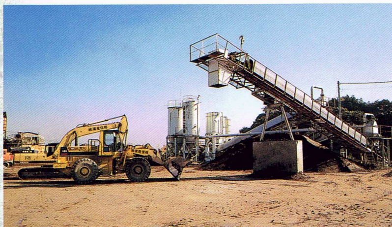
平塚土砂汚泥改良プラント ■ 800t/日
